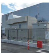
宮城物流センターの自家発電設備
