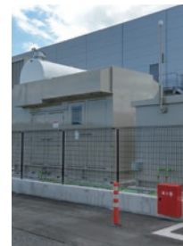
宮城物流センターの自家発電設備
